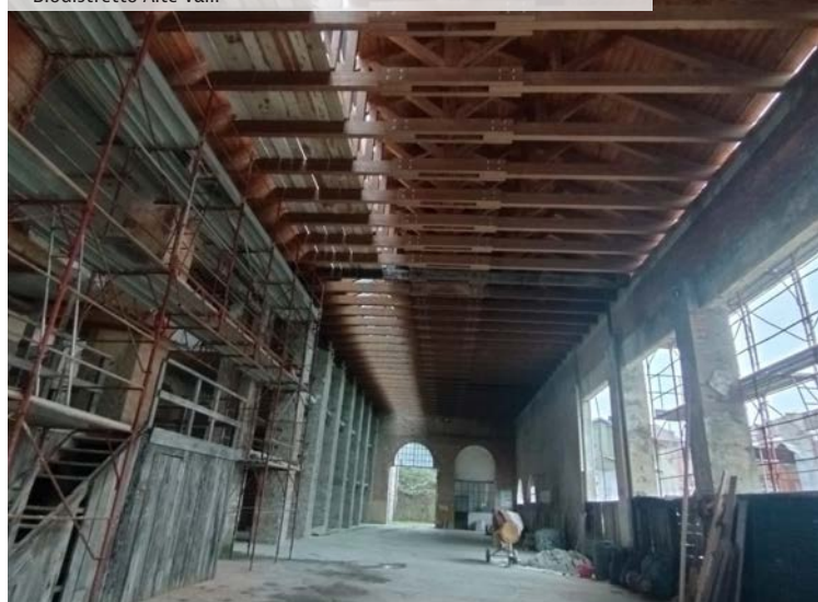
Lavori in corso per la realizzazione di Cibaria, il mercato coperto del Biodistretto Alte Valli
